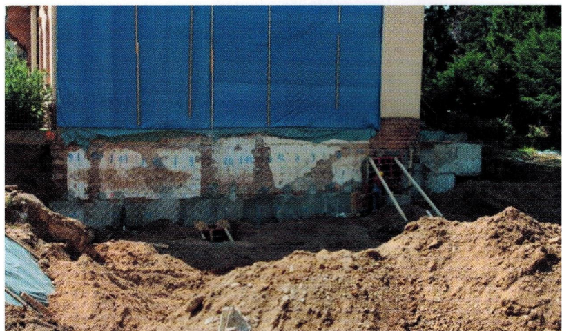
Als Ursache der Rissbildungen an dem Mehrfamilienhaus gilt die direkt angrenzende Baustelle. Foto: Nutzungsgenehmigung Peter Hammacher
