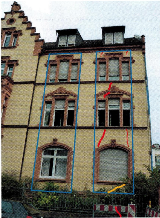
Gravierender Schaden: Die Fassade weist mehrere Rissverläufe auf.
